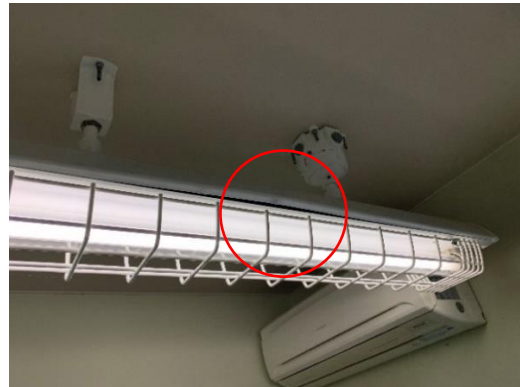
写真 19 蛍光灯の変形箇所 (丸印) (調査時)
