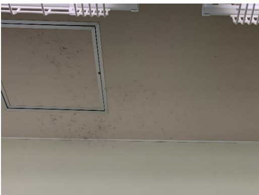
写真 18 天井の状態 (調査時)
