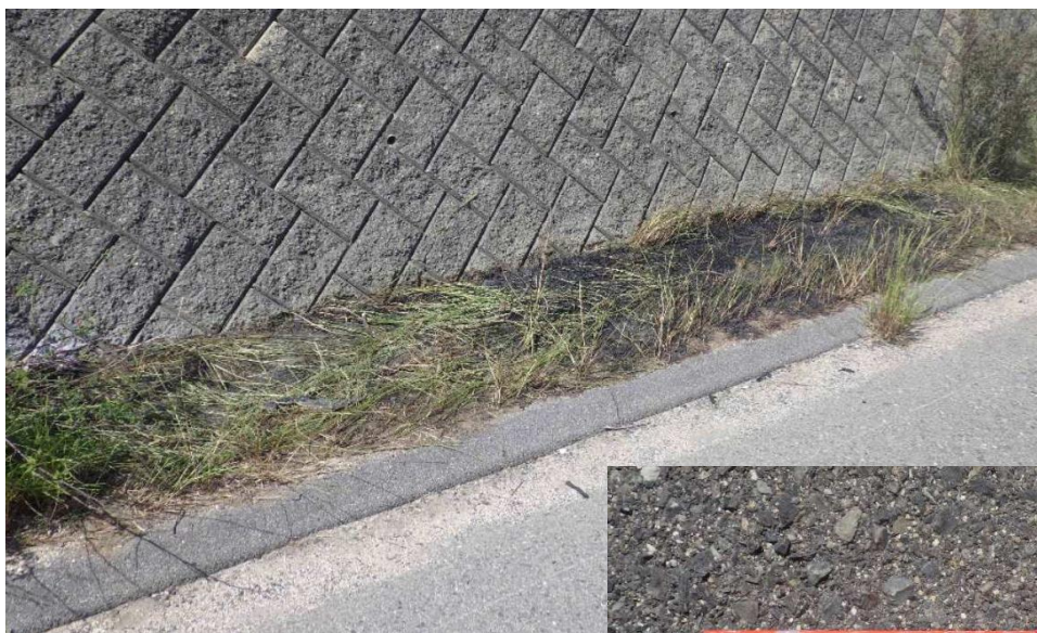
写真 焼失した路側帯の下草と使用した道路作業用信号炎管
