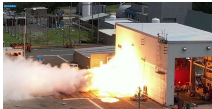
異常発生直後(南側)
