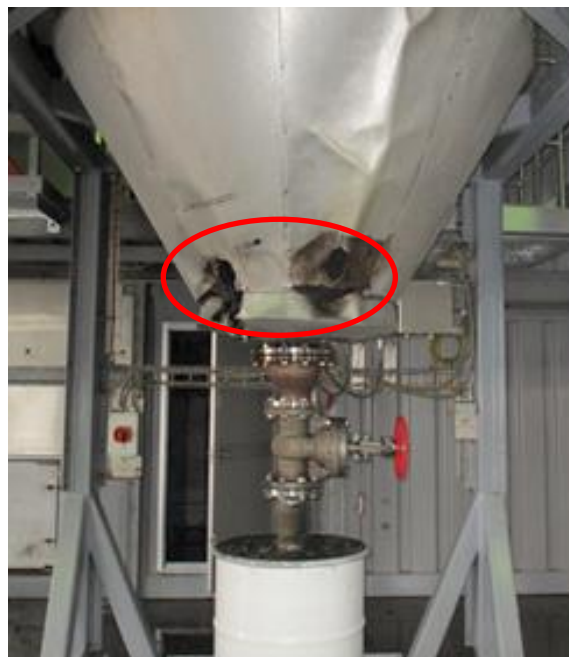
発生個所拡大（外装撤去前）
