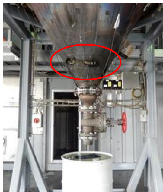
発生個所拡大（外装撤去後）
