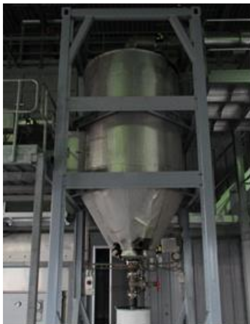
バッファータンク外観（外装撤去前）
