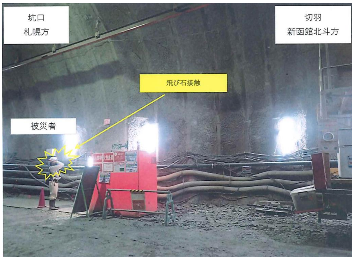
写真2 被災状況全景
