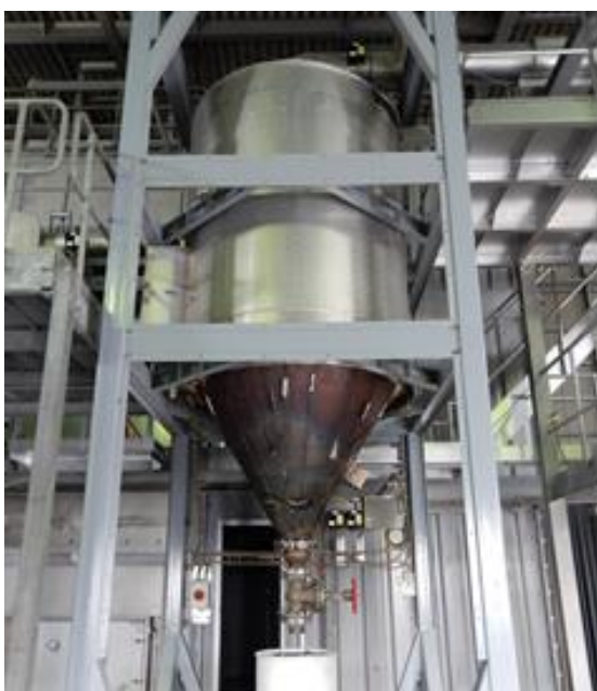
バッファータンク外観（外装(下部)撤去後）
