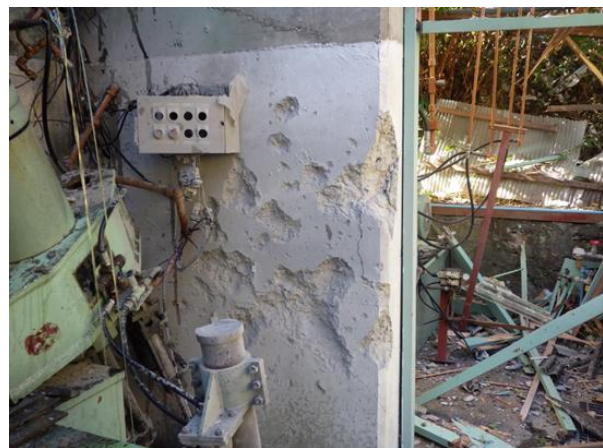
防爆壁破損状況
