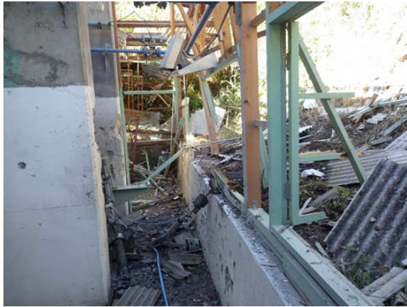
圧填室側破損状況
