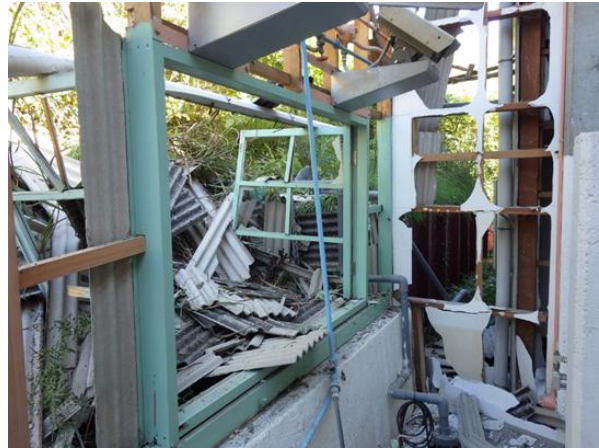
圧填室側(搾孔機側)破損状況
