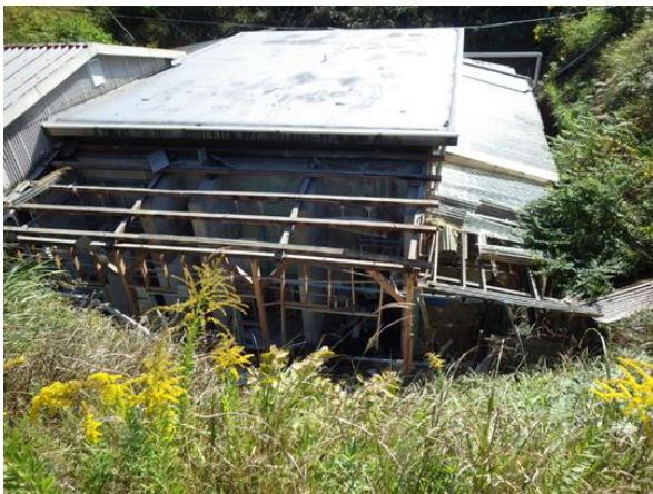
圧填室側破損状況(土堤上部より)
