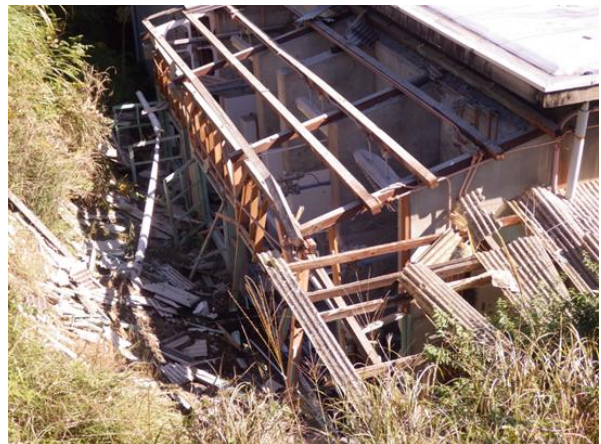
圧填室側破損状況(土堤上部より)
